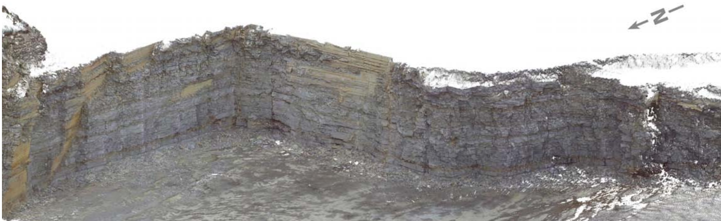
Steinbruch in Klieve bei Anröchte: Ergebnis der Laserscan-Vermessung mit fotorealistischer Darstellung in schräger Aufsicht
